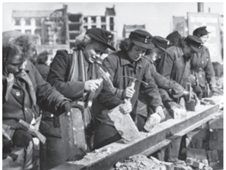
Auferstanden aus Ruinen: „Freiwilliger Entrümmungsdienst der weiblichen Volkspolizei“ hielt Heinz Krüger auf der Rückseite des Fotos fest, Berlin, 8. März 1952
